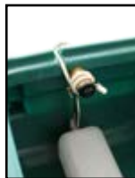
avec un câble chauffant autour du flotteur
